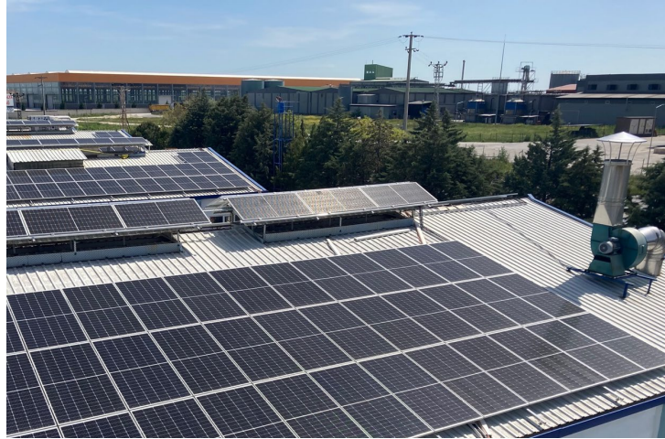
Güneş Enerjisi Projesi
